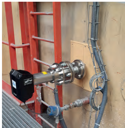
交叉管道，在线燃烧监测
