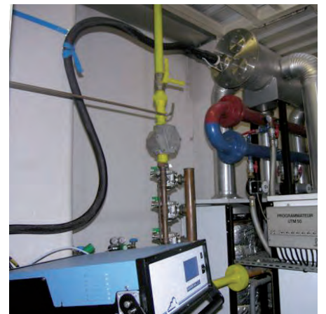
工业炉燃烧气体的监测
