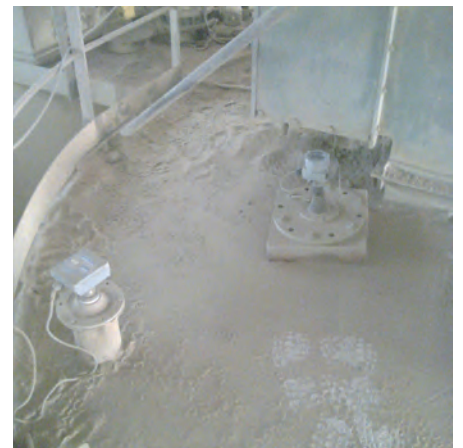
筒仓内的连续料位检测
